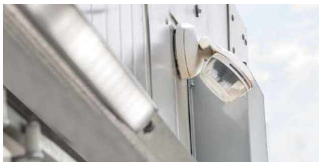
Éclairage extérieur avec détecteur de mouvement
